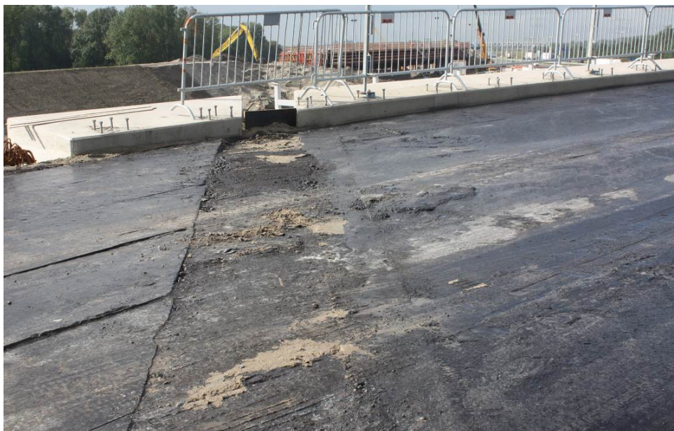
Figuur B6.3 Informatief: Vervuiling van kleeflaag door materiaal uit voegsparring
